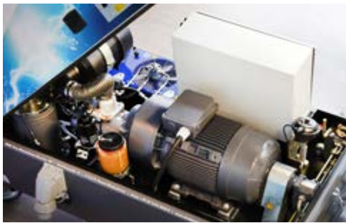
Der frequenzgesteuerte 30 kW Elektromotor
