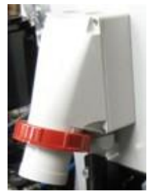
Steckdose Steuerschrank innen
