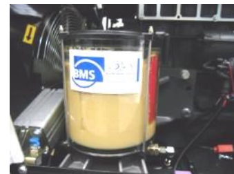
Vorratsbehälter der Zentralschmierung
