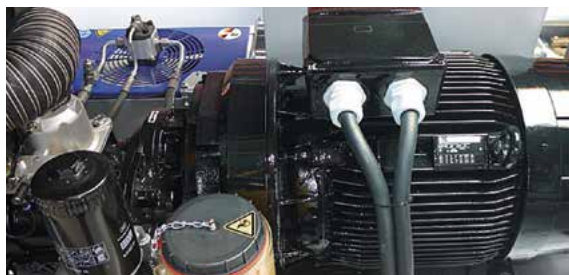
Der frequenzgesteuerte 30 kW Elektromotor
