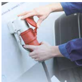
Anschluss für Baustellenstrom
