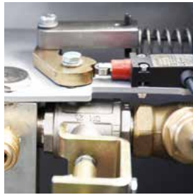
Sicherheitsabschaltung Domsieb im Innenraum
