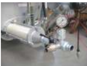
Förderpumpe Hier mit montiertem Ansatz Manometer und Kugelhahnventil
