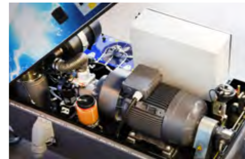
Le moteur électrique de 30 kW à commande par fréquence
